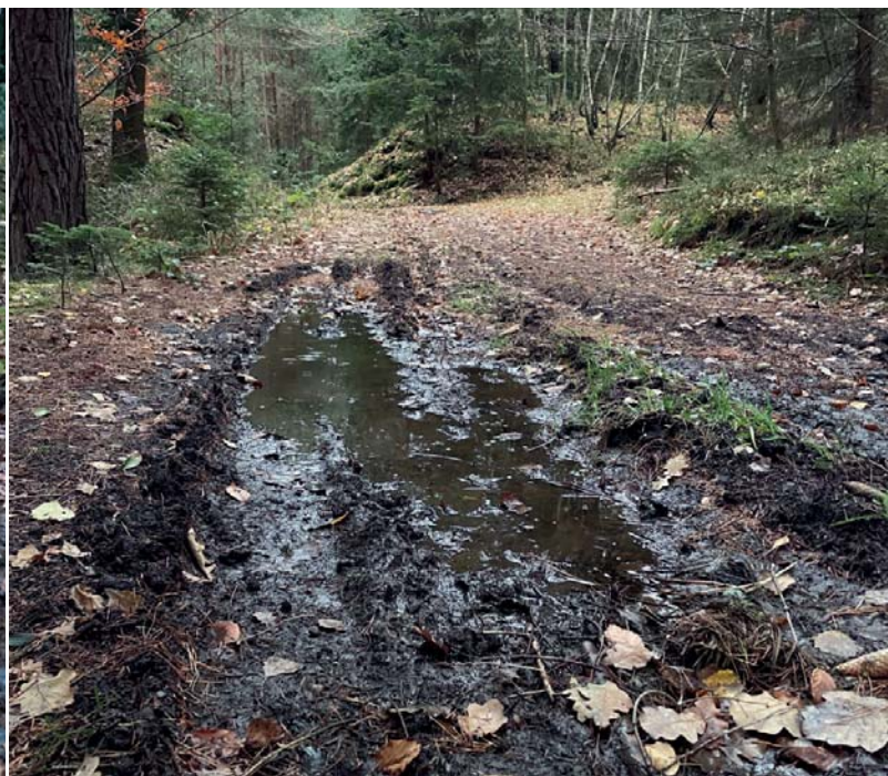
Neodvodněná lesní cesta
